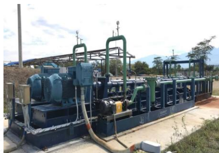
Sistema de Bombeo Electrocentrífugo Horizontal
